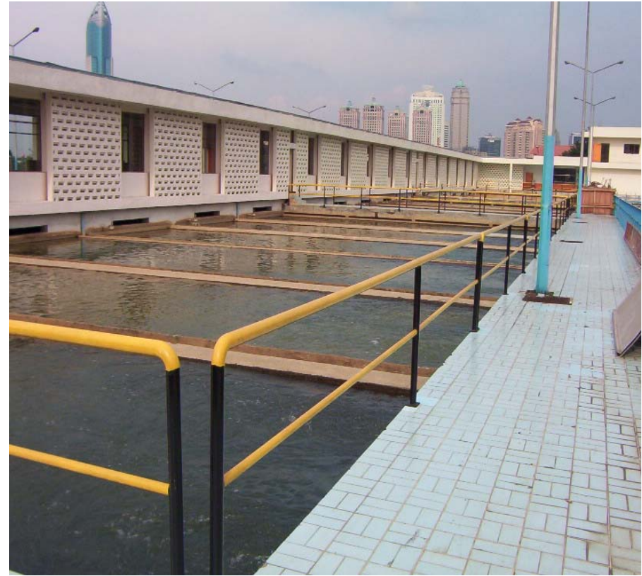
WTP Pejompongan 2 (Degremont 1965)
